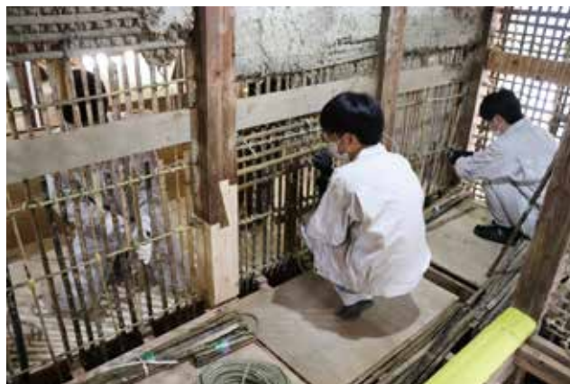
豪雨により被災した建物の修復作業 Restoration of a building damaged by downpour
