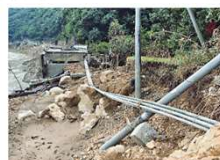
国道267号線土壁際の崩壊
