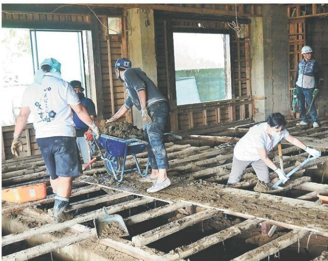
1階天井まで浸水した人吉旅館。壁や天井を落とした後、床下の泥出しをする女将の堀尾里美さん(右手前)や従業員ら＝8月24日、人吉市
