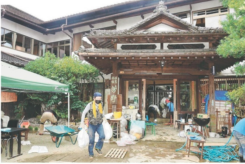
従業員やボランティアが床下の泥出しを進める芳野旅館 = 8月24日、人吉市
