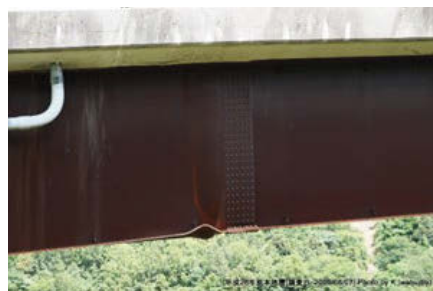
図1 俵山大橋の座屈被害
