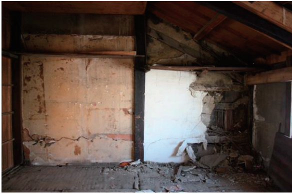
図 1.1 S 邸との境界の壁（平成 28 年 10 月 24 日撮影）
