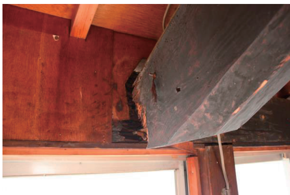
図 1.3 仕口が千切れる梁（平成 28 年 10 月 24 日撮影）
