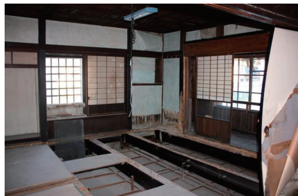
図 2 5 二階座敷の襖の変形と白アリ被害（平成 28 年 12 月 6 日撮影）
