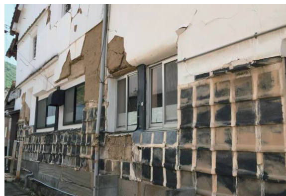
図 2 4 剥落している外壁（平成 28 年 5 月 30 日撮影）
